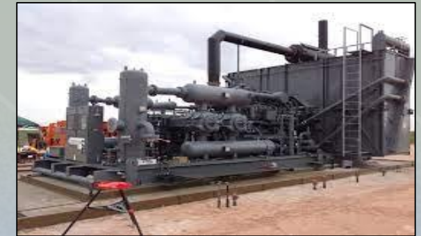
Onshore Production (Energy Central)
